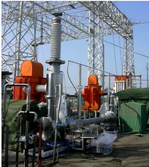
図 2. 1. 3-13 課電試験システム外観
